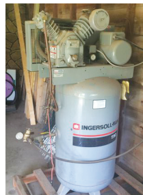
Ingersollrand 80 gal air compressor.
